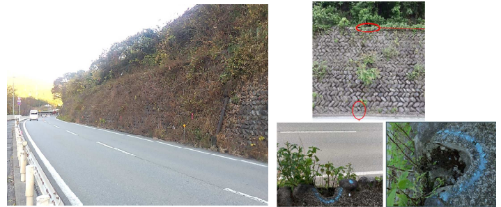
写真-3.1 玉石の抜け落ちが発生
